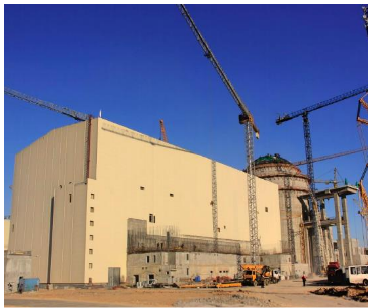
Рисунок 6 - Здание турбины Белорусской АЭС
